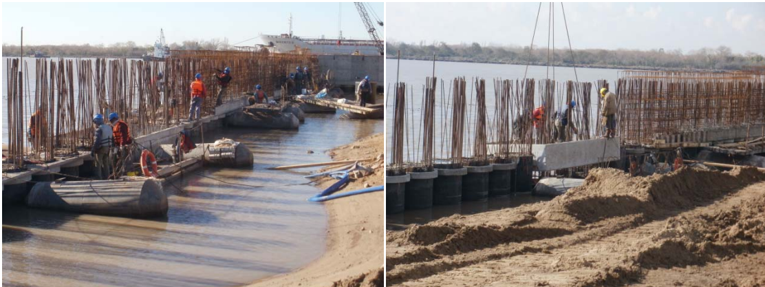
Fotos 18 y 19 – Encofrado mediante casacas de hormigón en sección inferior de viga
