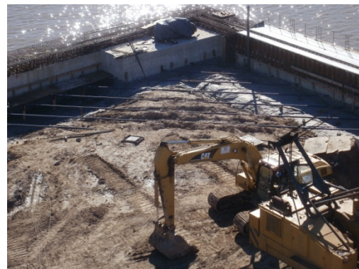
Foto 17 – Tensores esquina Norte
