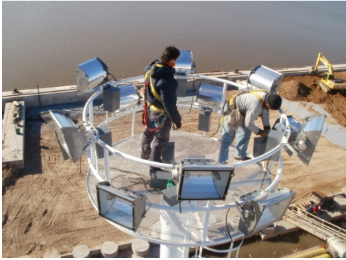
Foto 22 – Torre de iluminación de 24 m, 12 luminarias
