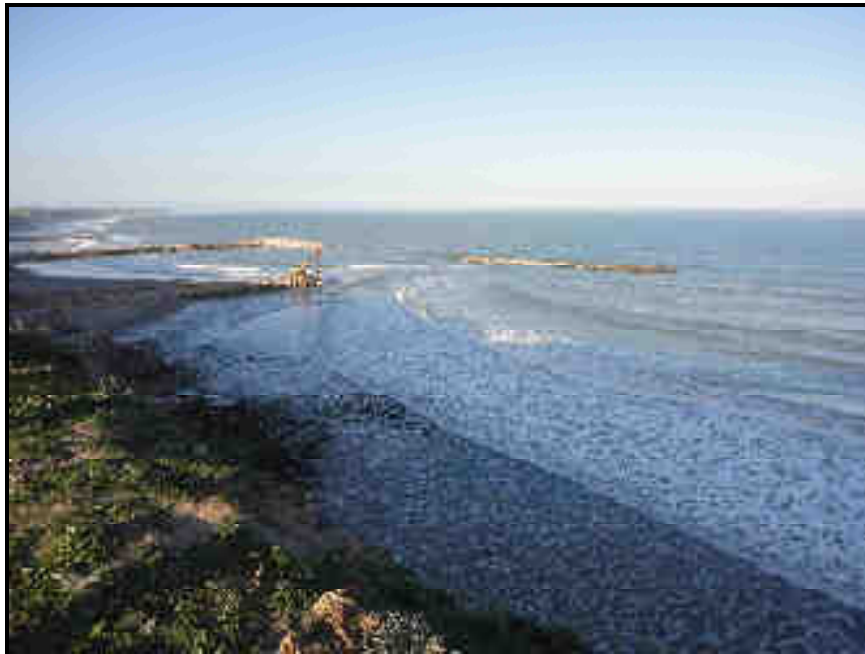
Fotografía N°4: Rompeolas desvinculado y remoción del espigón de acceso
