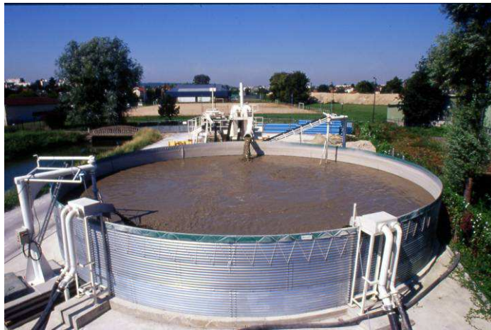
Tanque de homogeneización
