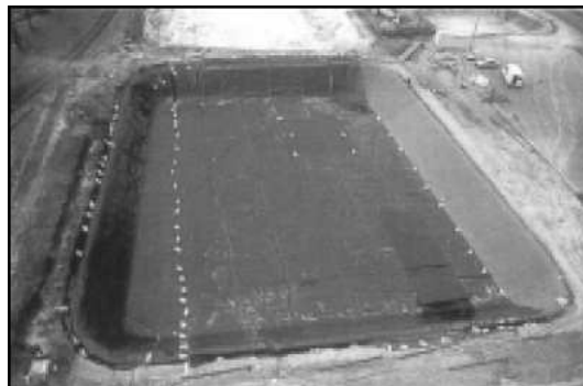
Celda de contención
