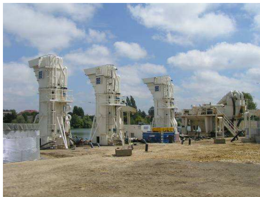
3 torres de clarificación de agua
