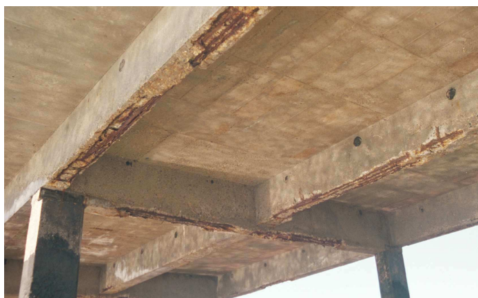
Figura 1: Corrosión de armaduras en una estructura portuaria
