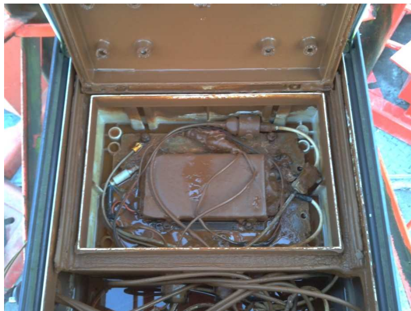
Figura 3: Estado que puede regresar una instalación
