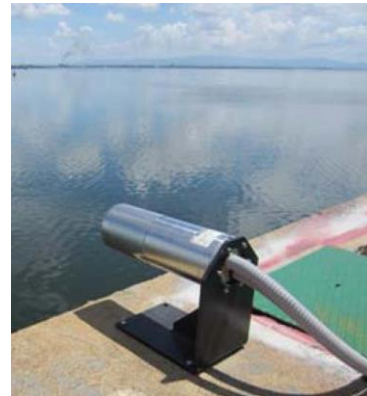
Figura 14. Láser típico en su carcasa protectora para una terminal de petróleo o gas.
